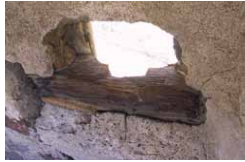
Abb. 11 Glurns (Meran, Südtirol) Eingemörteltes Prellholz in einer Mauercharte der Stadtbefestigung
